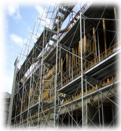
本足場（枠組足場）の例
